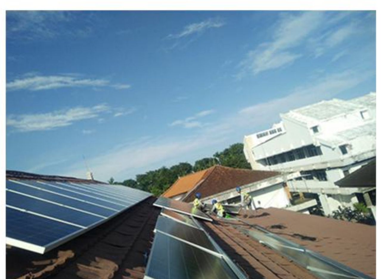
PLN AREA BALI SELATAN (2021) 31.500 WP
